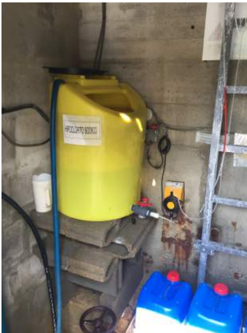
Foto 39: Sistema dosificación depósito de Vilaza
