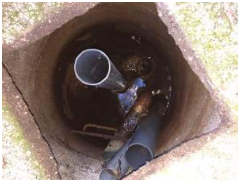
Foto 9: Interior pozo de registro captaciones Vilaza
