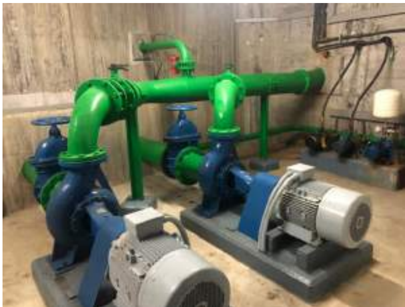
Foto 26: Equipos en caseta depósito
