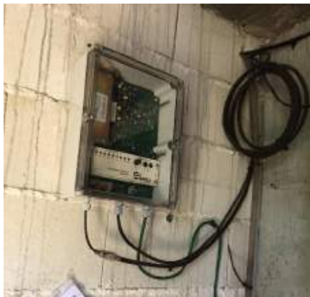
Foto 35: Telemando depósito de Donas
