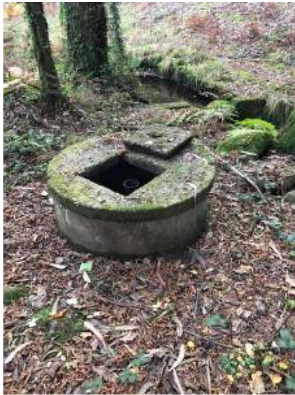
Foto 8: Exterior pozo de registro captaciones Vilaza
