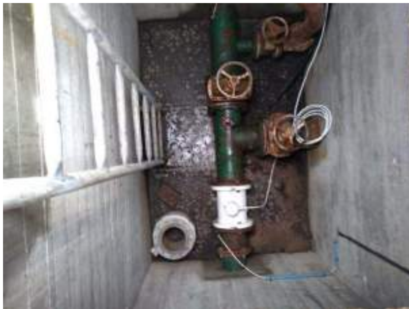
Foto 13: Vista caudalímetro entrada a ETAP
