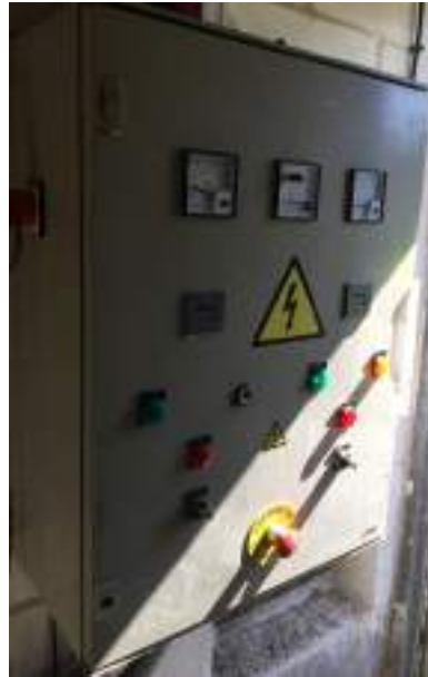
Foto 42: Cuadro eléctrico EBAL de Donas
