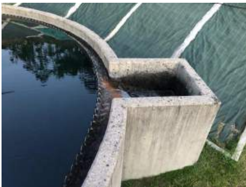
Foto 16: Salida decantador a filtros en ETAP
