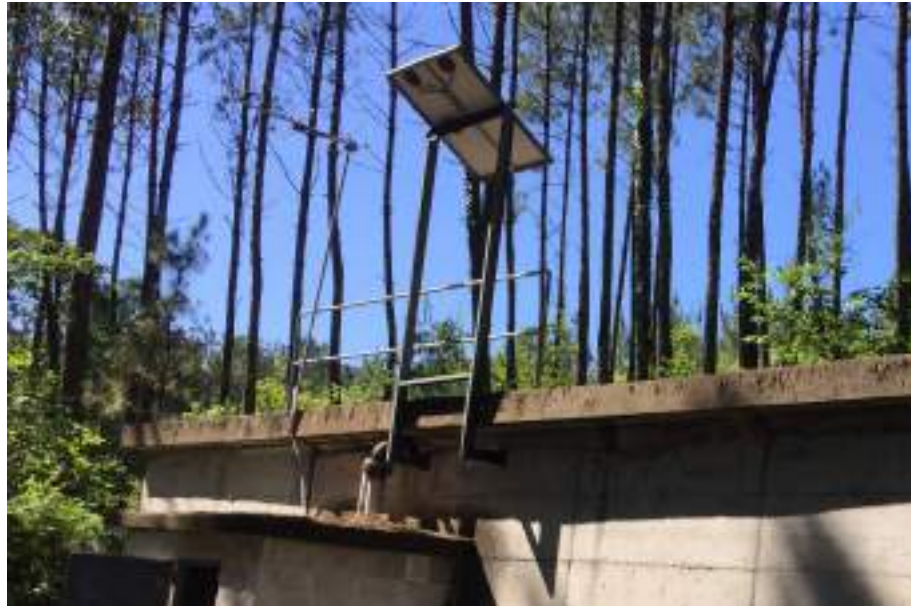
Foto 36: Paneles fotovoltaicos depósito de Donas
