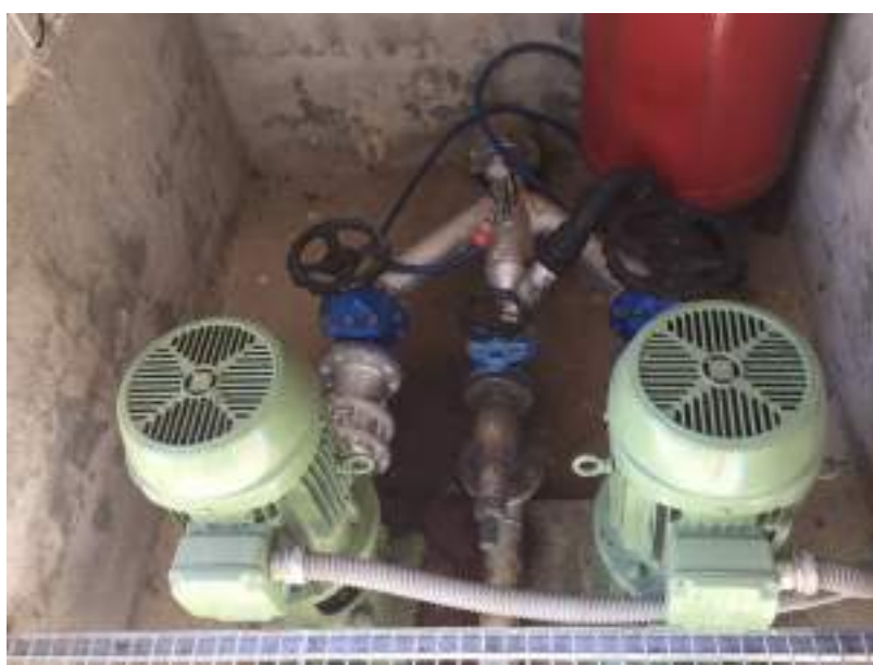
Foto 41: Bombas EBAL de Donas
