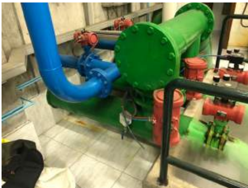
Foto 17: Salida de filtros, aire (tuberías azules) y agua lavado (colector verde) en ETAP
