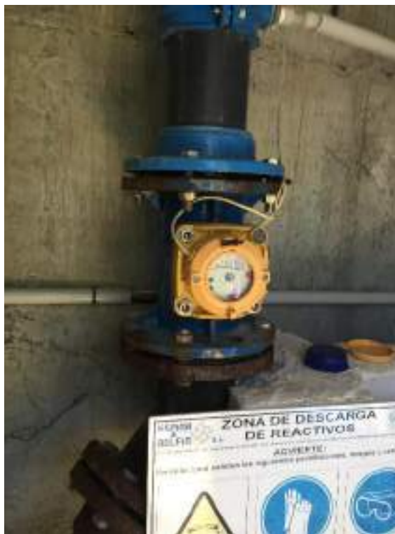
Foto 32: Contador de entrada a depósito de Donas
