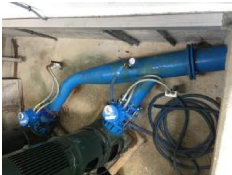
Foto 5: Colector impulsión en pozo de bombeo de captación de Gondomar
