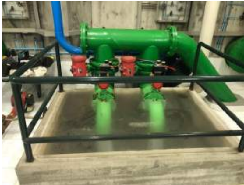
Foto 22: Salida filtros en ETAP
