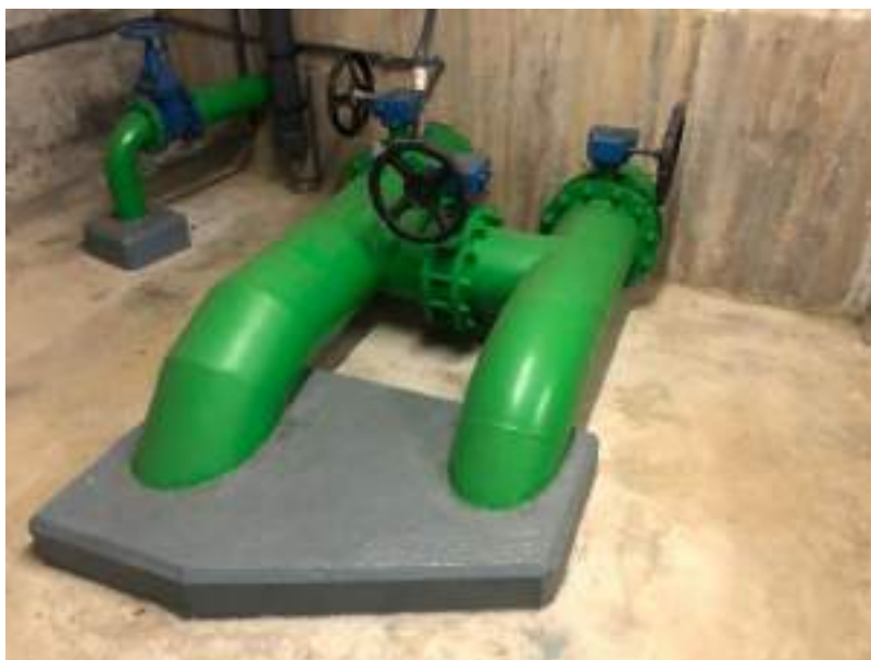
Foto 27: Entrada (tubería derecha), salida (tubería izquierda) y bypass
