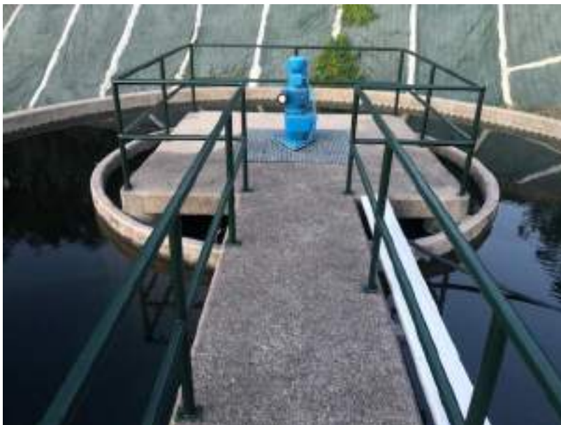
Foto 15: Parte superior decantador en ETAP
