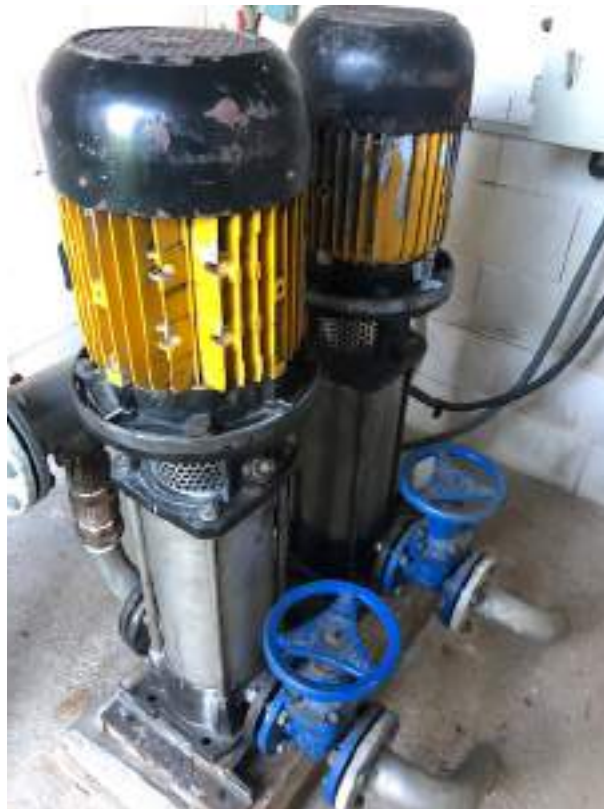
Foto 44: Bombas EBAL de Vilaza
