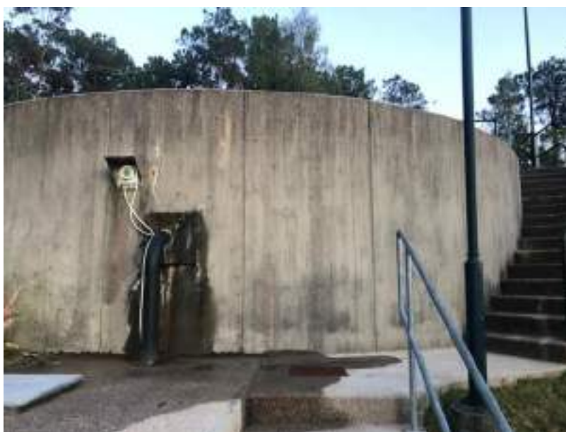
Foto 14: Vista exterior decantador en ETAP
