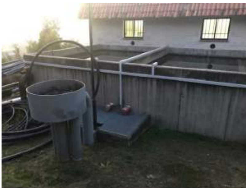
Foto 20: Vista exterior filtros y arqueta reparto a filtros en ETAP
