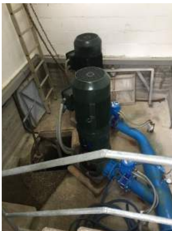
Foto 3: Sala de Motores en pozo de bombeo de captación de Gondomar
