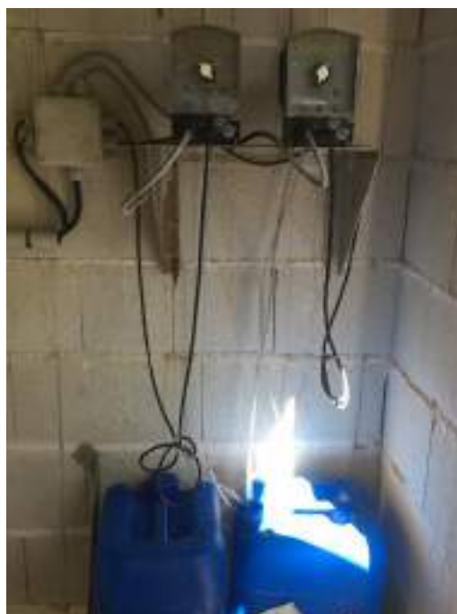
Foto 33: Sistema dosificación depósito de Donas
