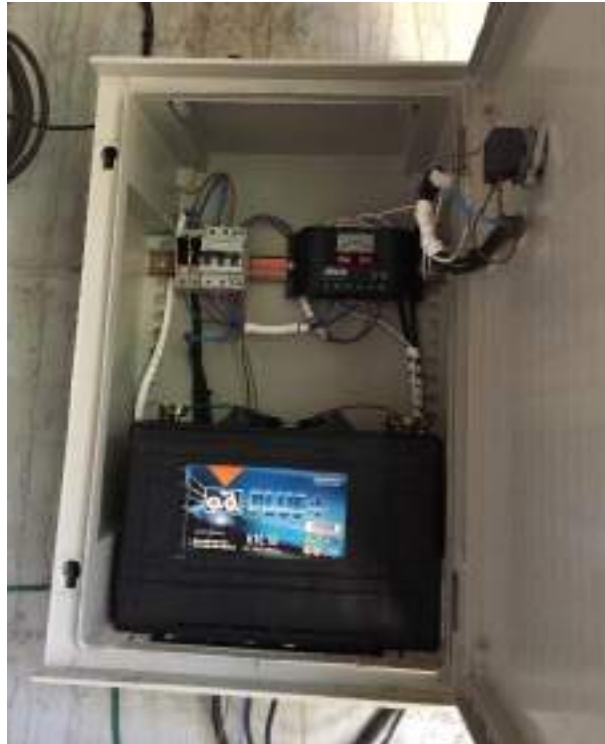
Foto 34: Sistema alimentación fotovoltaico depósito de Donas
