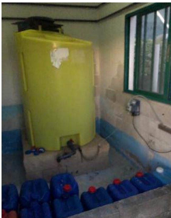
Foto 24: Interior caseta cloro en ETAP
