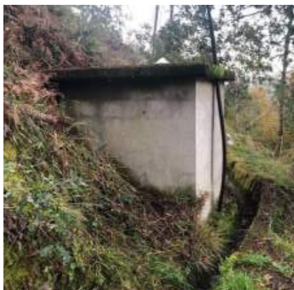
Foto 6: Foto de cámara de descarga de captación de Gondomar
