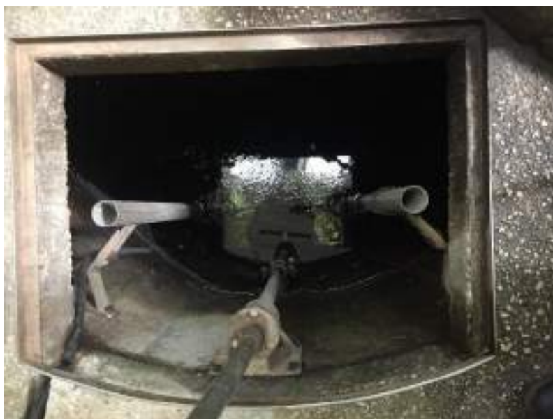
Foto 4: Tajadera y cestón a la entrada del pozo de bombeo de captación de Gondomar
